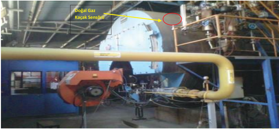
Fotoğraf 16 - Doğal Gaz Kazanı Besleme ve Akış Kontrol Vanaları (Bakım Platformu Üzeri Doğal Gaz Kaçak Sensörü Mevcut - Nokta Ölçümü)
