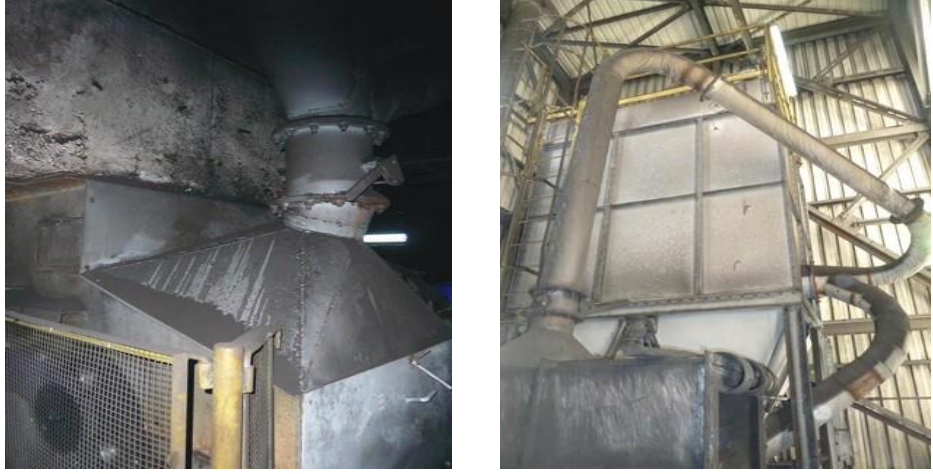
Fotoğraf 3 – Ham Kömür Konveyör Transfer Noktası Tozsuzlaştırma Boruları
