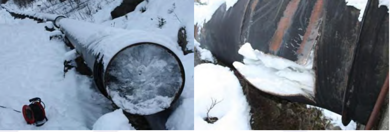
Őekil 18 Cebri Boru Donma Hasarları
