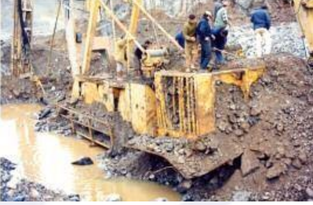
Őekil 15 - Hidroelektrik Santrali İnŐaatında Sel Sonrası Rüsubat Birikimi
