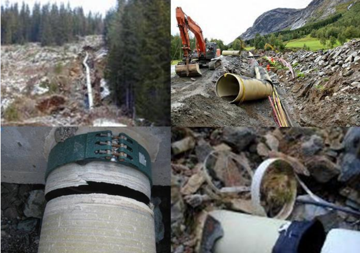
Őekil 17 Cebri Boru Hasarları
